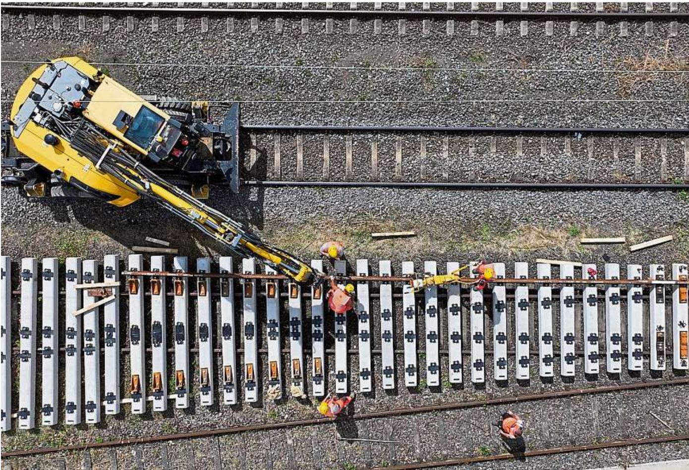
Die Verkehrsinfrastruktur soll nach den Plänen der schwarz-roten Koalitionäre grundlegend saniert werden.
