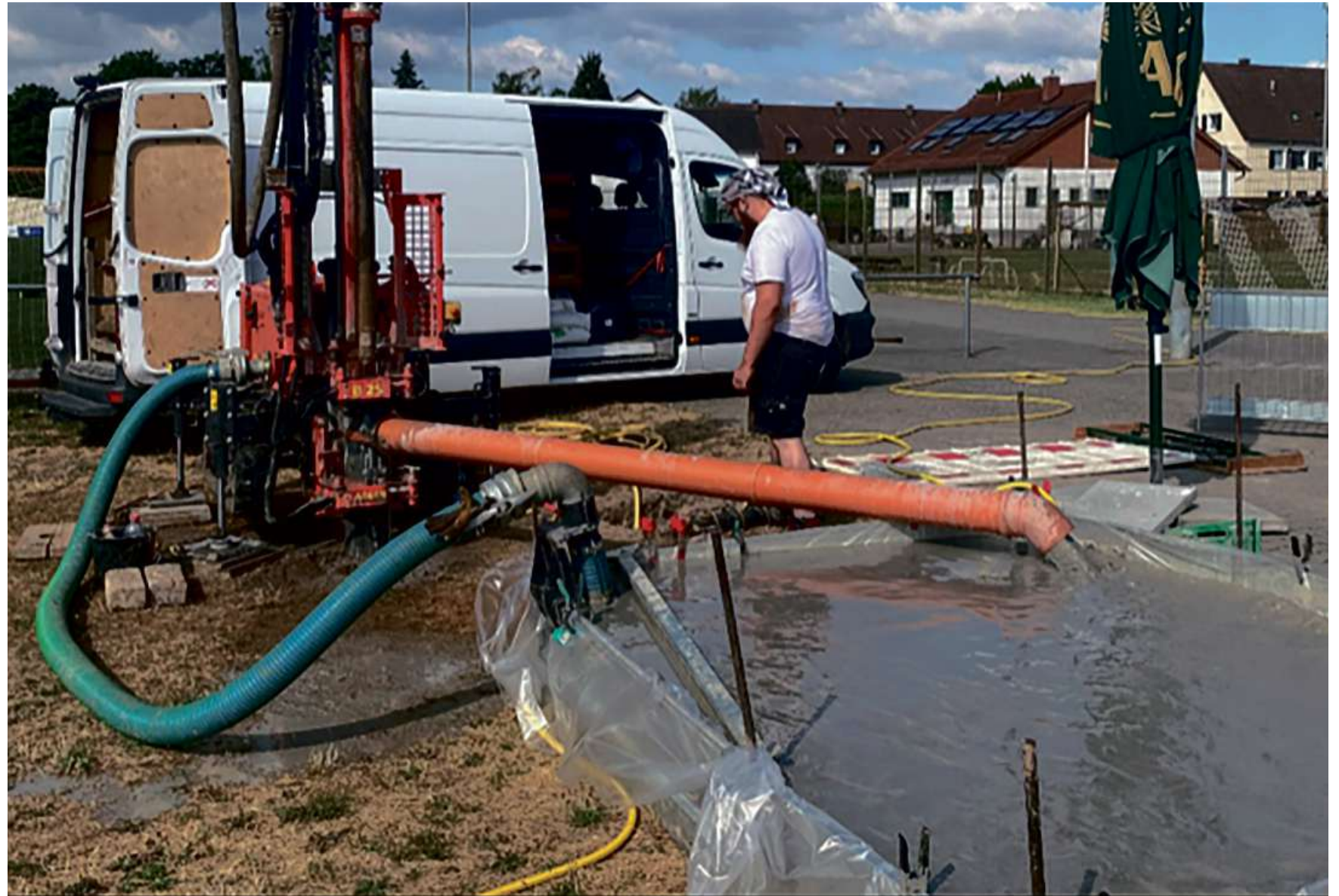
Das Großprojekt Bewässerungsanlage wurde durch den Ausfall der Brunnenanlage notwendig und mit Bravour von der Arbeitsgruppe der Senioren gemeistert. Es war aber auch ein immenser Kostenpunkt.
