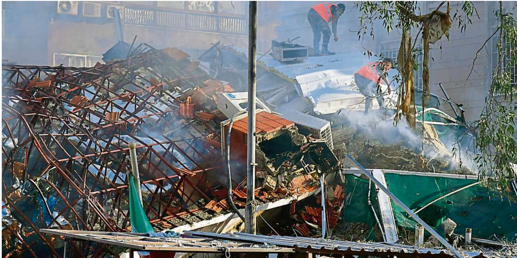
Retterkräfte in den Trümmern eines zerstörten Gebäudes auf dem Gelände der iranischen Botschaft in Syrien.
