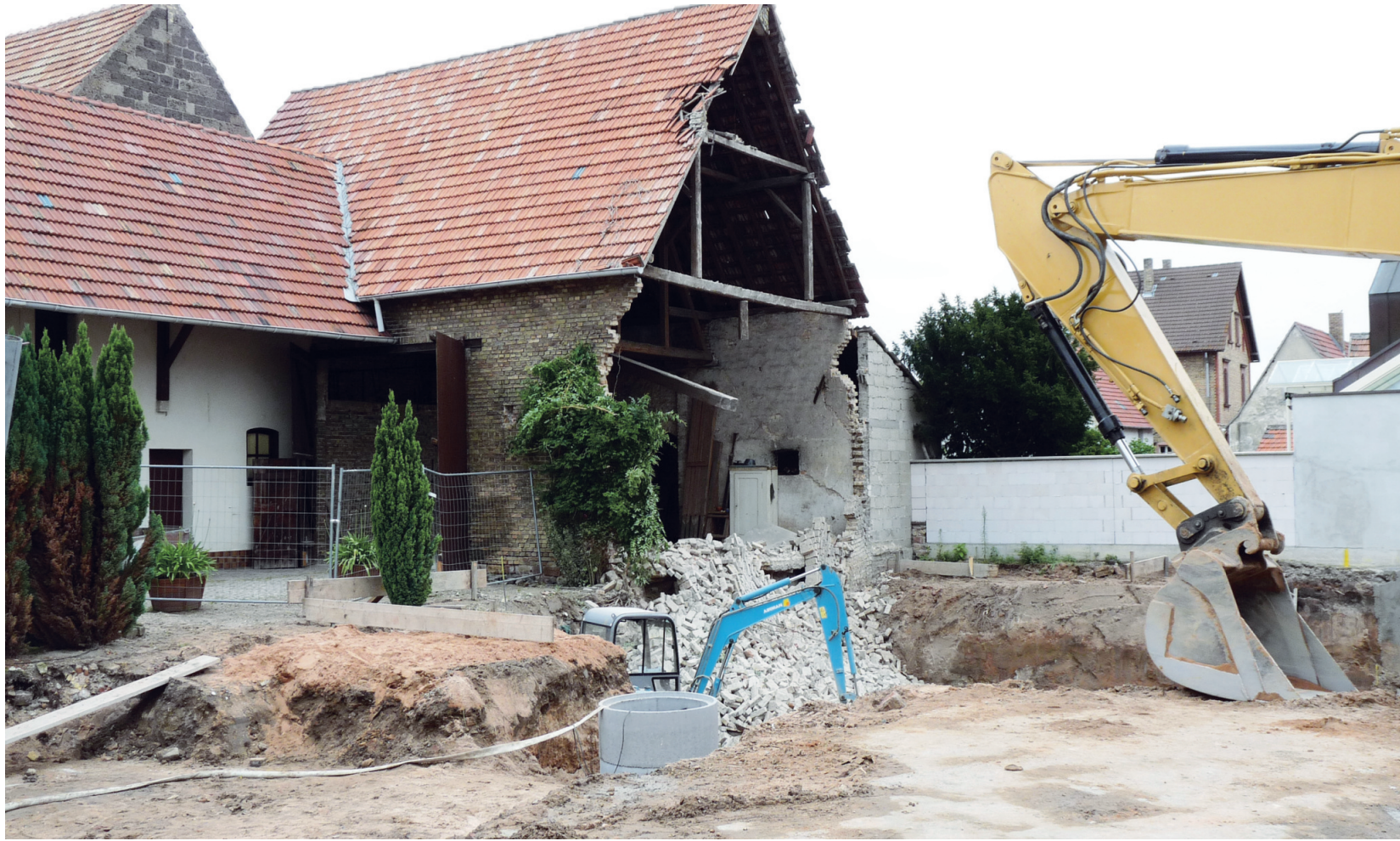
Arbeiten an einem Neubau auf dem angrenzenden Grundstück brachten eine Giebelwand von Liesl Romeis über 70 Jahre alten Scheuer zum Einstürzen. Der Bauherr versprach den Aufbau, nichts geschah. Die Familie klagte. Das Urteil ist gesprochen. 3815 Euro und fünf Prozent Zinsen seit Prozessbeginn werden Romeis gezahlt. Die Mauer liegt immer noch in Trümmern. Fotos:privat
